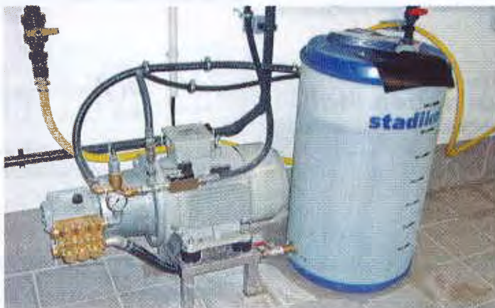
Für Stallanlagen bieten sich stationäre Hochdruckreiniger an. Das Wasser wird über Hochdruckleitungen bis vor die einzelnen Abteile gefördert. Lange Rüstzeiten entfallen vollständig.
