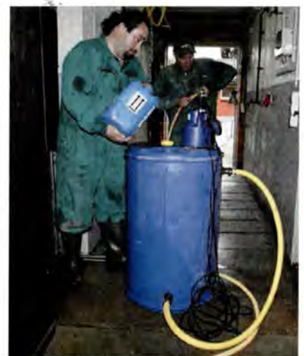
Die Wasserleitungen werden chemisch – erst sauer, dann alkalisch und zum Schluss mit Wasserstoffperoxid – gereinigt und desinfiziert.
