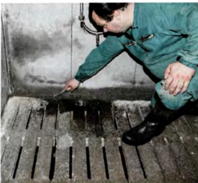
Damit kein Schmutz sich erneut festsetzt, werden von VarEx Lücken wie diese hinter dem Spaltenboden mit Beton versiegelt.
